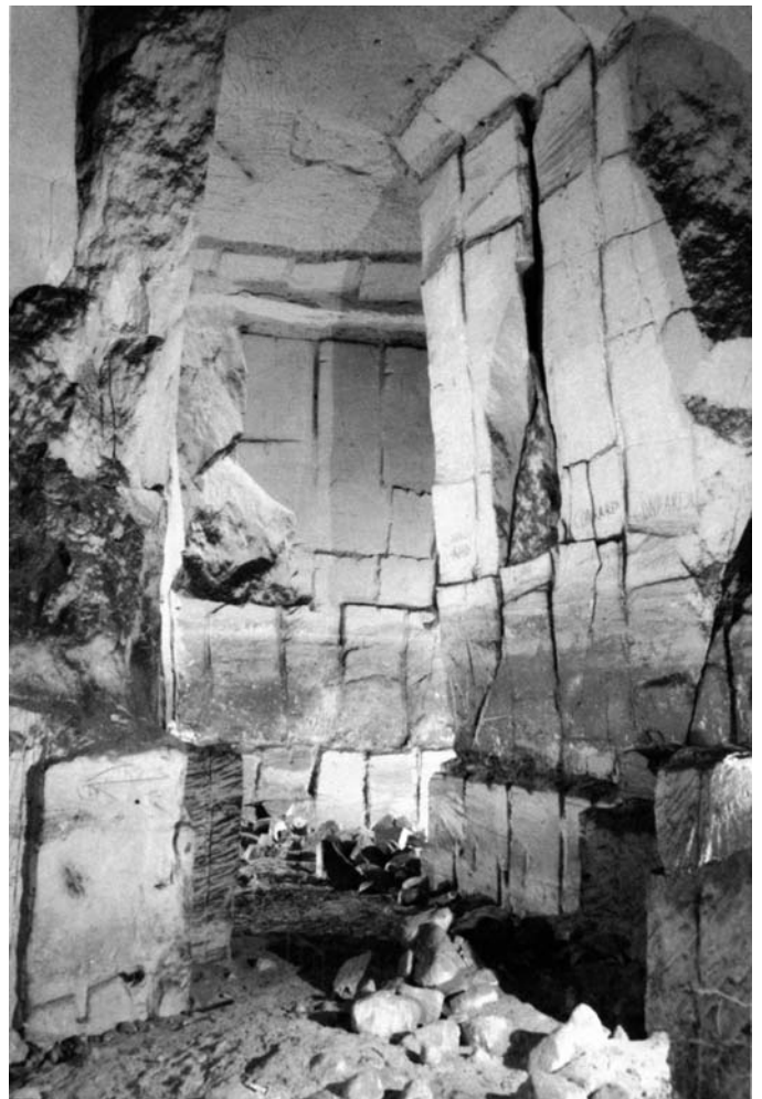
Gang in de Heerderberg. Let op de scheuren in de pilaren. foto: Henk Ramakers
